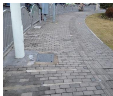
图4 路口转弯道板砖上的斜三角水泥缝
