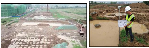
图 2 地下水埋深浅及工程现场雨季积水情况
