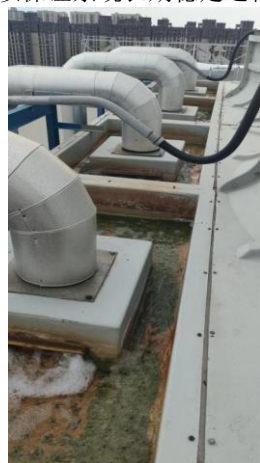
图2 冷却塔进水孔堵塞
