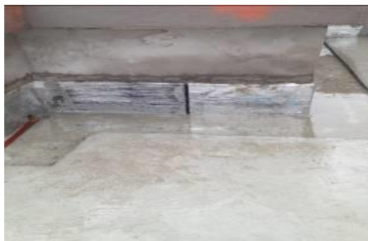
图3 女儿墙根部无凹槽、卷材直接铺贴在墙根
