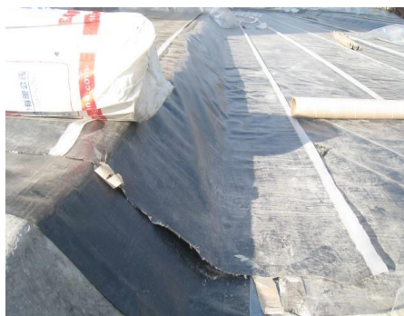
图 1 地下室顶板防水卷材翘边现场图
