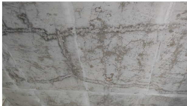
图1 地下室顶板在局部堆载后产生的贯通裂缝
