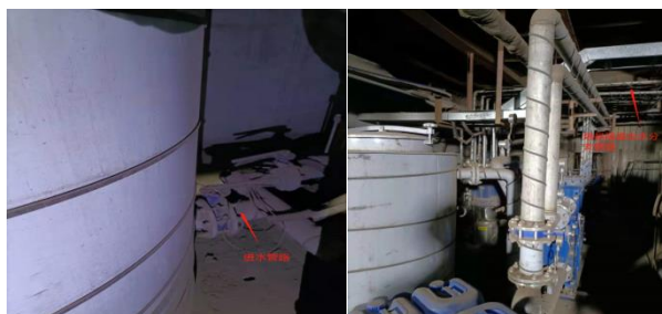
图3 进水管路 图4 结晶器进回水分支管路
