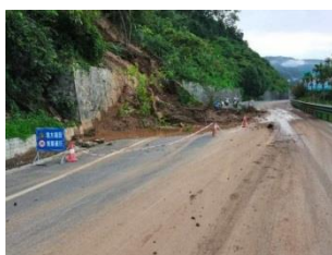
图 7 土质上边坡滑塌
