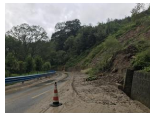
图5 土质上边坡滑塌
