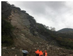
图1 石质上边坡垮塌
