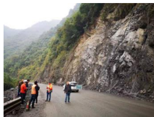
图 9 石质上边坡垮塌
