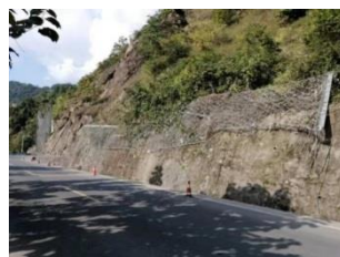
图4 原被动防护网损坏
