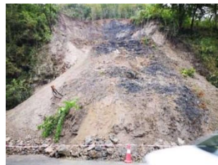
图2 土质上边坡垮塌
