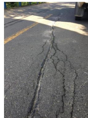
图1 沥青路面裂缝图
