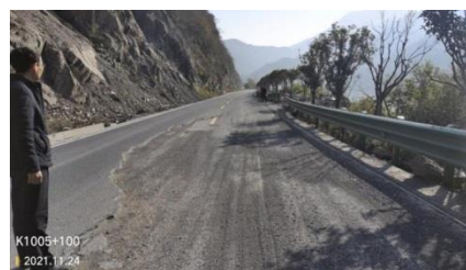
图2 路基自身结构体系的变形塌陷
