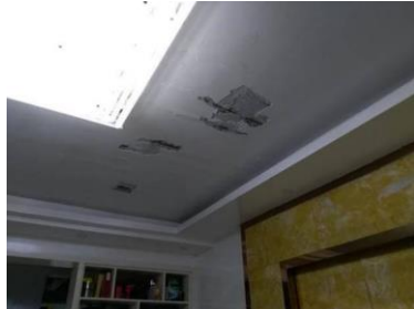
图 1 现浇板钢筋锈胀、锈胀
