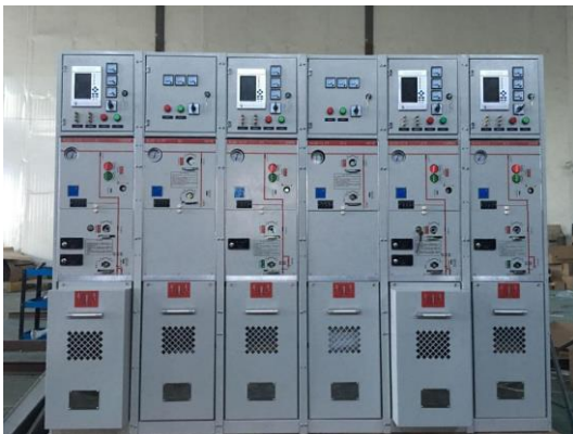
图2 10kV 配电环网柜控制器
