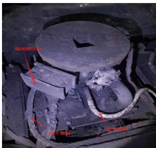
图5 金属软管连接进回水管路结晶器
