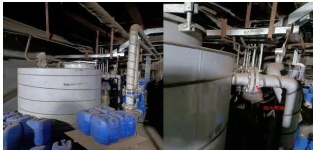
图 1 电磁搅拌储水设备 水箱
