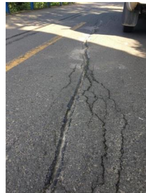
图1 沥青路面裂缝图
