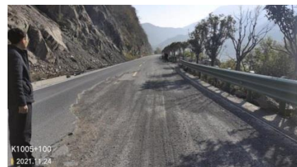
图2 路基自身结构体系的变形塌陷
