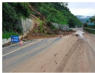
图7 土质上边坡滑塌
