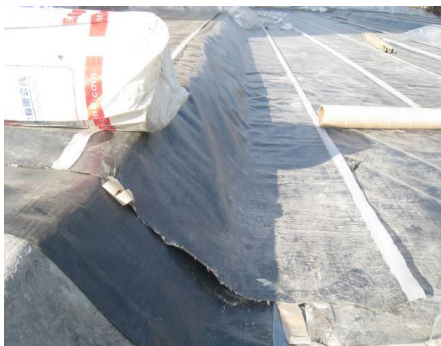
图1 地下室顶板防水卷材翘边现场图
