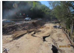
图 2 S309 路面下沉情况
