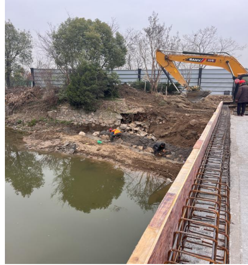
图1 老驳坍塌方事件施工现场
