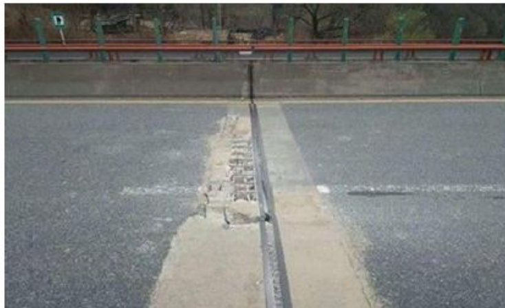
图2 农村公路老桥的伸缩缝病害
