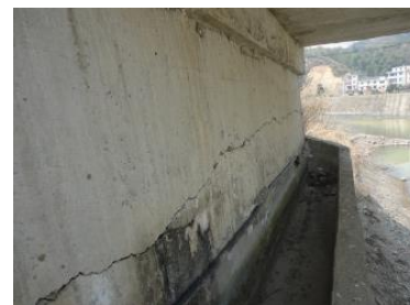
图1 农村公路老桥的桥台裂缝
