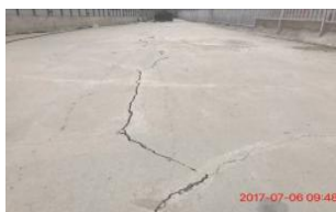
基坑南侧硬化面开裂 6m 长，5mm 宽
