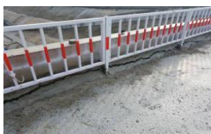
基坑南端头硬化路面与挡墙竖向裂缝，最大时宽 5cm
