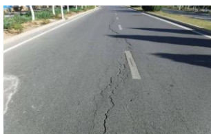
滨河路北侧主路纵向裂缝，3cm 宽，深 20cm
