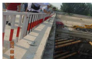
围护桩、挡墙向基坑内变形明显
