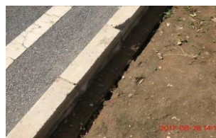
绿化带与路基纵向裂缝，3cm 宽
