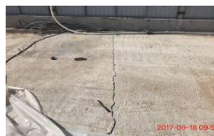
基坑南侧硬化面纵向裂缝 14m 长 4.5mm 宽
