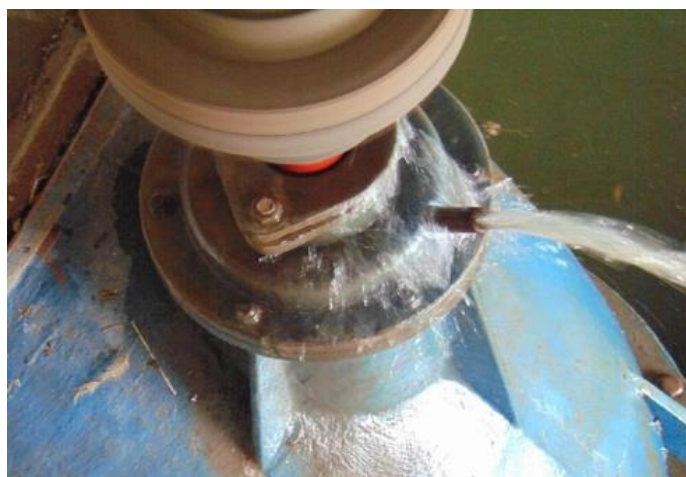
图3 水泵轴承磨损运行时漏水
