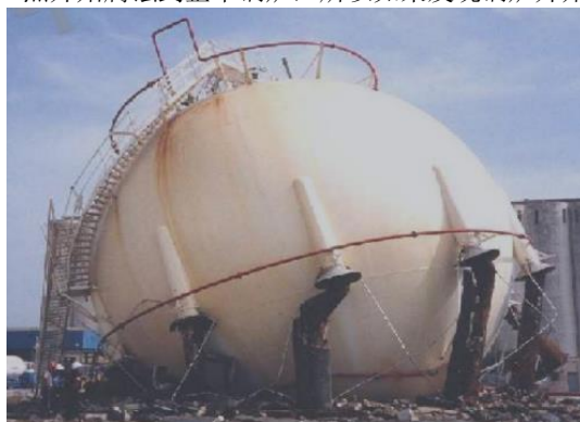
图1 腐蚀裂纹导致的球罐倒塌
