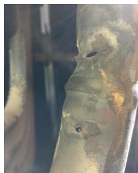
图 2 夹持管焊接接头漏点示意图
