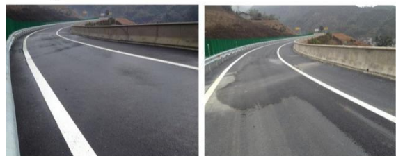
图3 沥青路面现场泛水图
