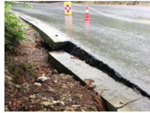
图5 路肩断裂下沉
