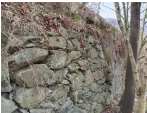
图3 干砌挡墙“鼓肚”变形
