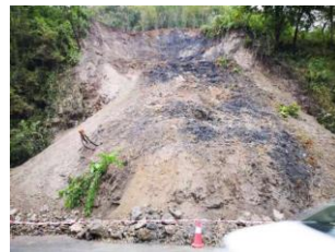
图7 土质上边坡滑塌
