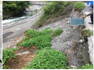
图6 下边坡失稳滑塌
