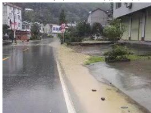
图11 集镇路段路基无排水设施
