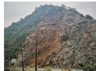
图8 破损石质上边坡垮塌
