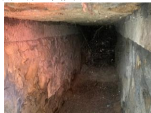
图12 涵洞进水口淤塞
