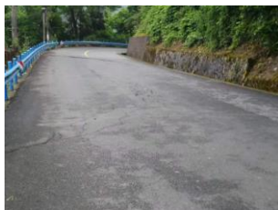
图9 路基路面沉陷
