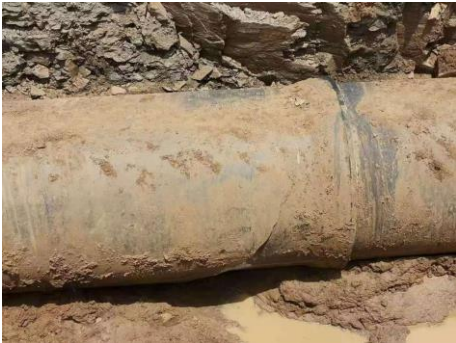
图9 因质量问题试压时管壁被打爆
