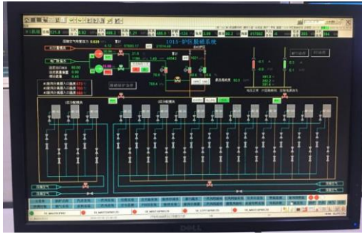
图 6 改造前深调负荷 125MW 脱硝系统
