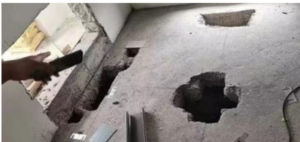
图2 电梯机房楼板预留洞和后开洞现场图
