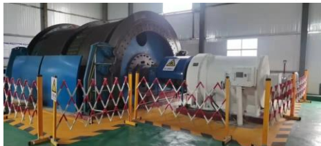
图1 现场使用永磁同步减速电机直驱矿井提升机
