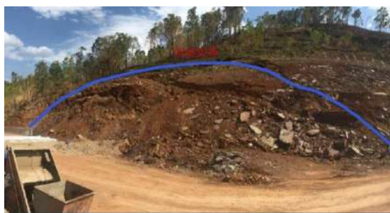
K9+650~K9+730 段滑坡现状
