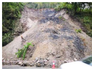
图7 土质上边坡滑塌
