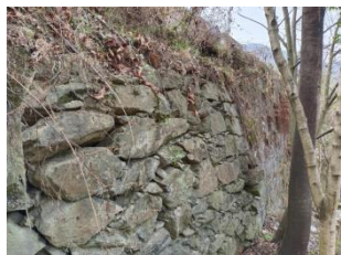
图3 干砌挡墙“鼓肚”变形
