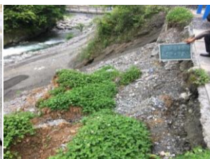
图6 下边坡失稳滑塌
