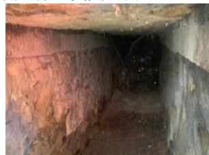
图12 涵洞进水口淤塞
