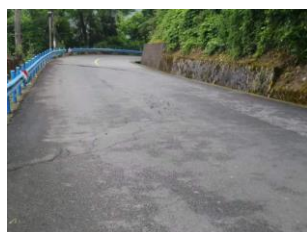
图9 路基路面沉降
