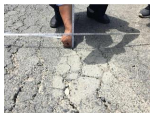
图10 路面沉降、龟裂
