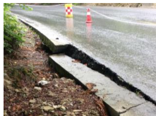
图5 路肩断裂下沉
