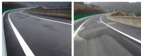
图3 沥青路面现场泛水图
