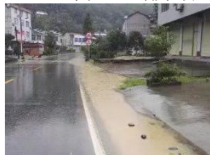
图11 集镇路段路基无排水设施
