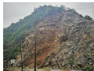
图8 破损石质上边坡垮塌
