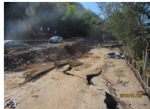
图 2 S309 路面下沉情况
