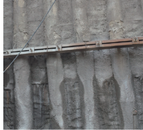
图6：大雨浸泡破坏后实景图
