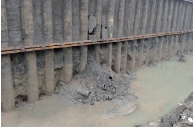
图5：大雨浸泡破坏后实景图
