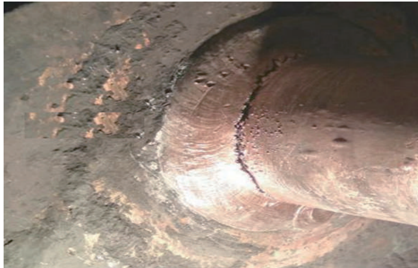
图1 铜冷却壁外部管根破损
