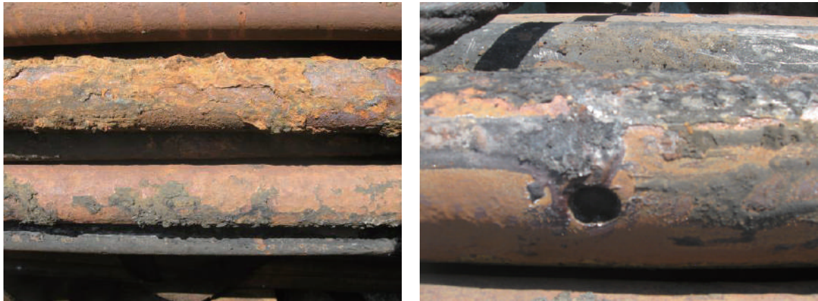
图3 腐蚀、结垢严重的注水井油管
