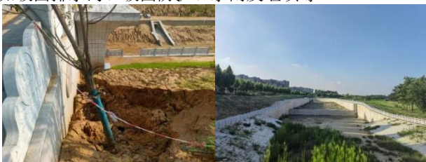
图4 河道坡面冲刷, 规划疏挖河道枯水期现状
