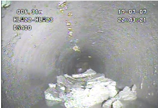
图2 管道内部存在沉积现象
