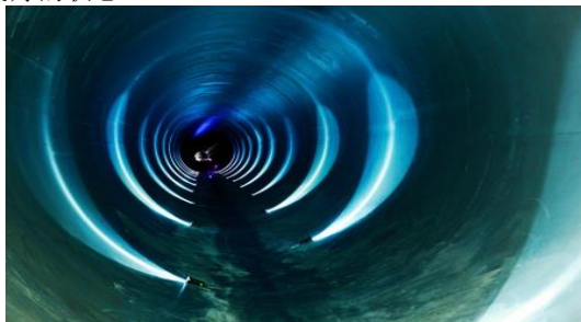
图3 管道内部存在沉积现象
