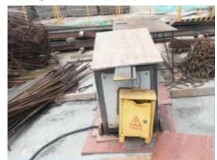
图6 现场钢筋加工安全隐患多
