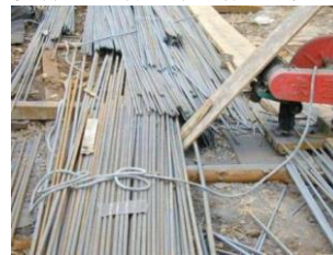
图5 现场钢筋加工安全文明施工差
