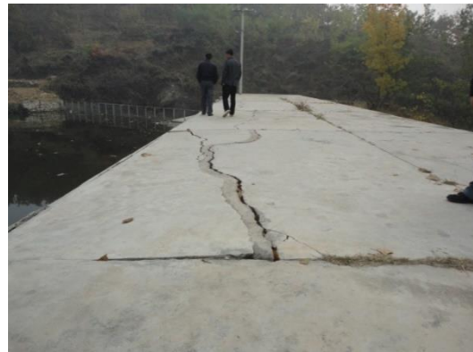
图 1 坝体裂缝及塌陷
