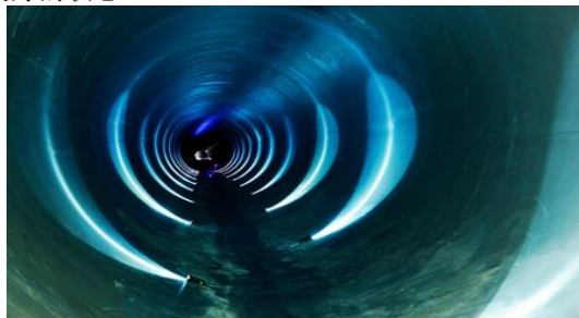
图3 管道内部存在沉积现象
