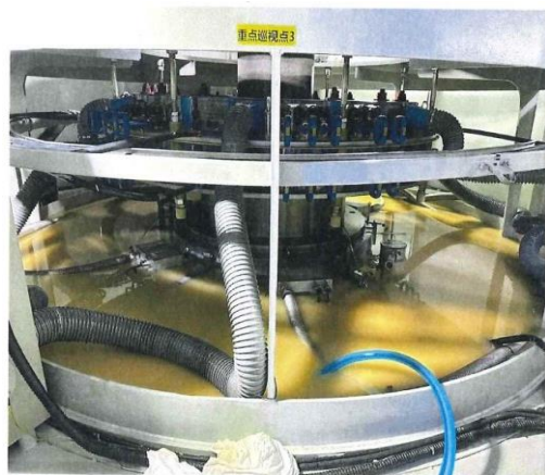
图2 漏油渗漏现场
