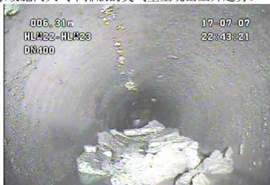
图2 管道内部存在沉积现象
