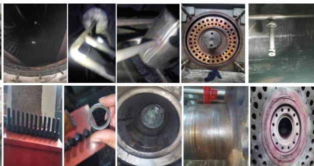
图2 真空转鼓过滤机现场故障部位图
