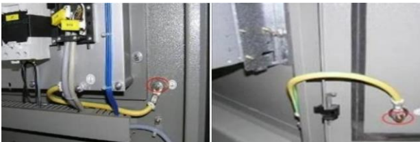
图 5 配电箱箱门与箱体接地跨接
