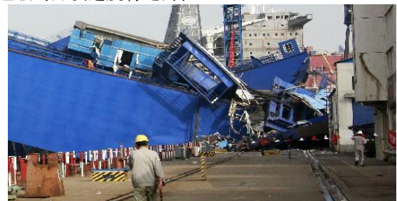
图2 因维护不到位导致的龙门架倒塌
