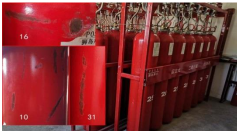
图 3 灭火剂钢瓶损伤
