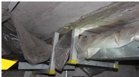
图 5 电缆表层被覆盖易燃物
