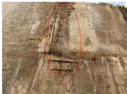
图11 大坝剥蚀、露筋
