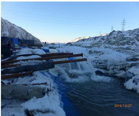
图 5 离心泵抽水状况
