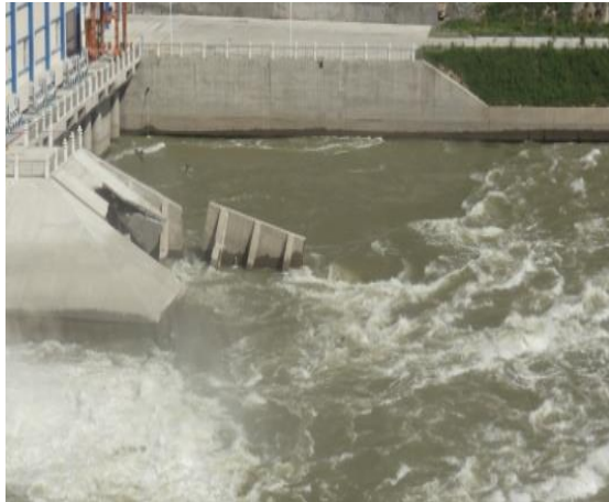
图1 被冲毁的尾水导墙
