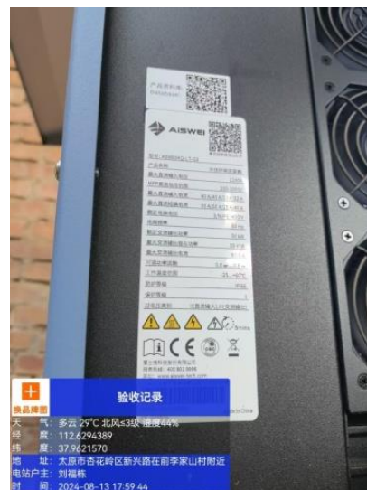
图 2 现场逆变器型号
