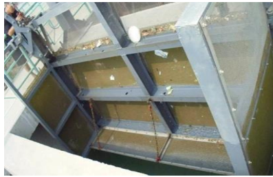
图5 总干渠漕河渡槽出口拦网所拦杂物
