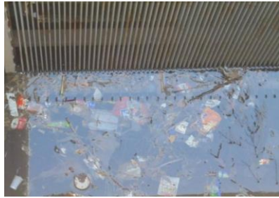
图3 高昌进水池清污机前杂物情况
