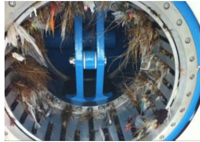
图4 高昌输水管道调流阀内杂物情况
