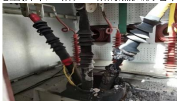
图 2 现场电缆头故障图
