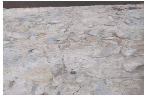
图 2 裂缝位置图(浇筑仓面处)
