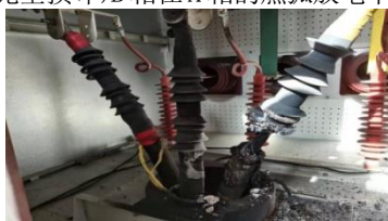
图 2 现场电缆头故障图
