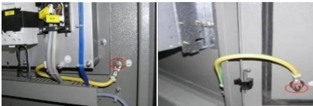
图 5 配电箱箱门与箱体接地跨接
