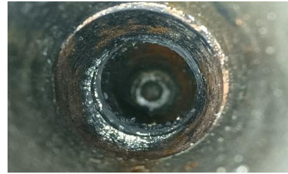
图4 风机叶片螺栓错位情况
