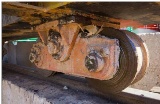
图4 起重机生锈腐蚀
