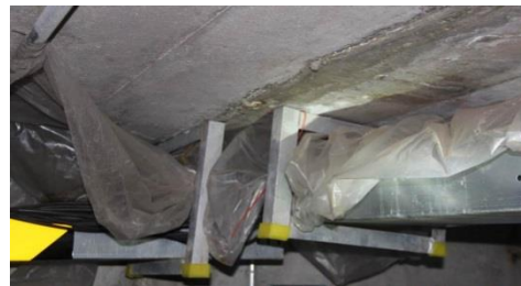
图 5 电缆表层被覆盖易燃物
