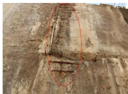
图11 大坝剥蚀、露筋
