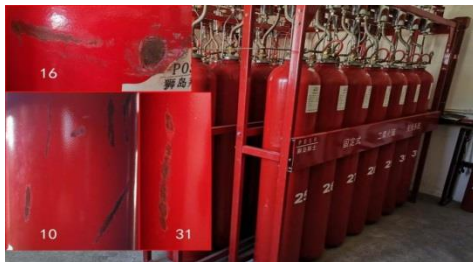
图 3 灭火剂钢瓶损伤
