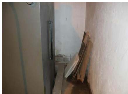
图9 设备间堆放杂物
