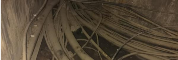
图 2 测试所使用的 110 千伏变电站电缆沟
