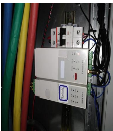
图 6 低压柜柜内无线传感器
