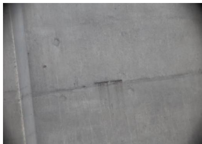
图 14 塔大桩号立面 19#节段 右下角露筋
